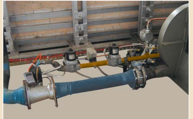
Premix gaz ve hava hattı Premix gas and air line Премикс газовые и наружные линии
